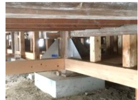
写 11 善興寺床下制震ガンパ
