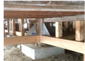
写 11 善興寺床下制震ガンパ
