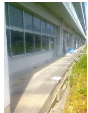
写3 河井小学校校舎傾斜
