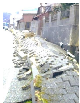
写4 埋設管浮き上がり
