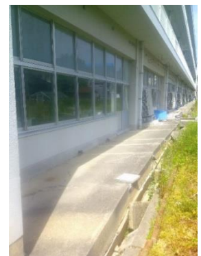
写3 河井小学校校舎傾斜
