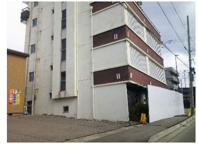
写2 濱田屋ビルの建物傾斜
