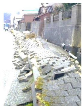
写4 埋設管浮き上がり
