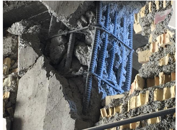
写真2 鉄筋コンクリート造の不適切な配筋 (2018年イラン・ケルマンシャー地震)
