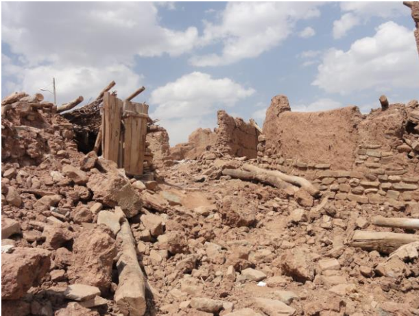
写真1 無補強組積造の住宅の倒壊 (2012年イラン・北西部(アハール)地震)
