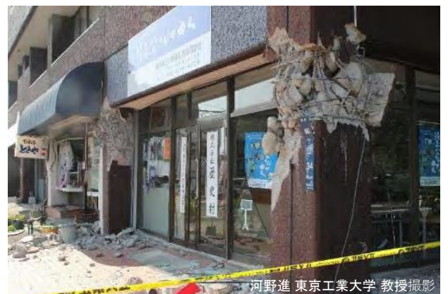
写真 6 熊本市東区・商業施設の RC 造の被害例 3)
