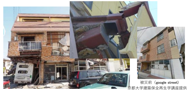
写真 5 益城町 R28 沿線における S 造の被害例 2)
