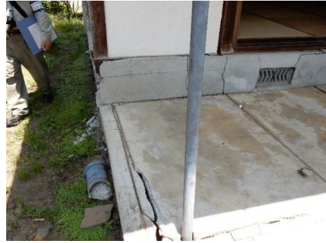
写真6 2016年熊本地震(益城町)
