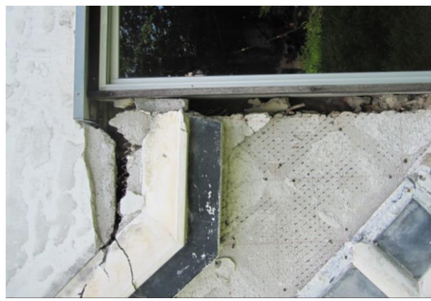
写真4 ラスモルタルで補修した箇所の被害例
