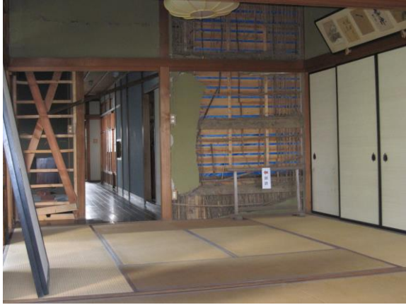
写真5 筋交い補強箇所周辺部の被害例
