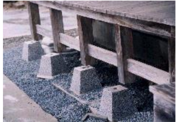
写真6 コンクリート基礎に改修後の被害例
