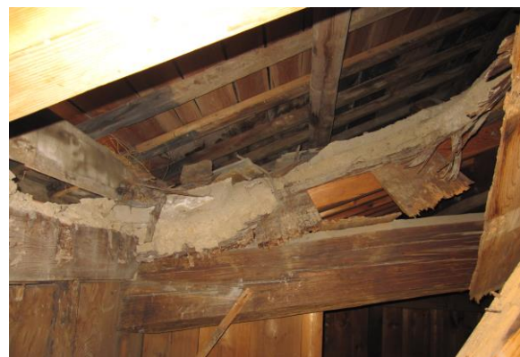
写真2 土蔵屋根の被害例（長年の雨漏りにより垂木・桁が腐朽し、地震で崩落）
