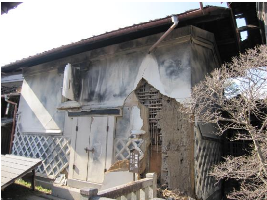
写真1 土蔵壁面の被害例（雨樋が補修されず、壁面を伝った雨水により壁体内部が腐朽し、地震で崩落）
