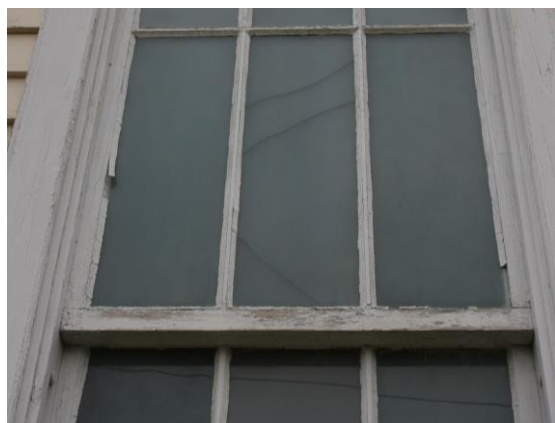
写真3 コーキング材の硬化によるガラス破損例
