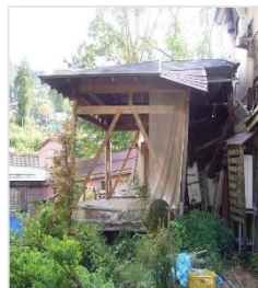
図11 倒壊した花舞台
