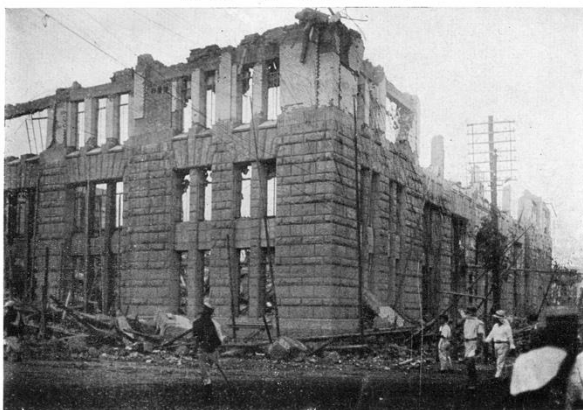
東京市麹町区丸の内 内外ビルディングの被害(其一)
